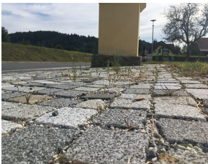
Vzhled spáry před sanací
