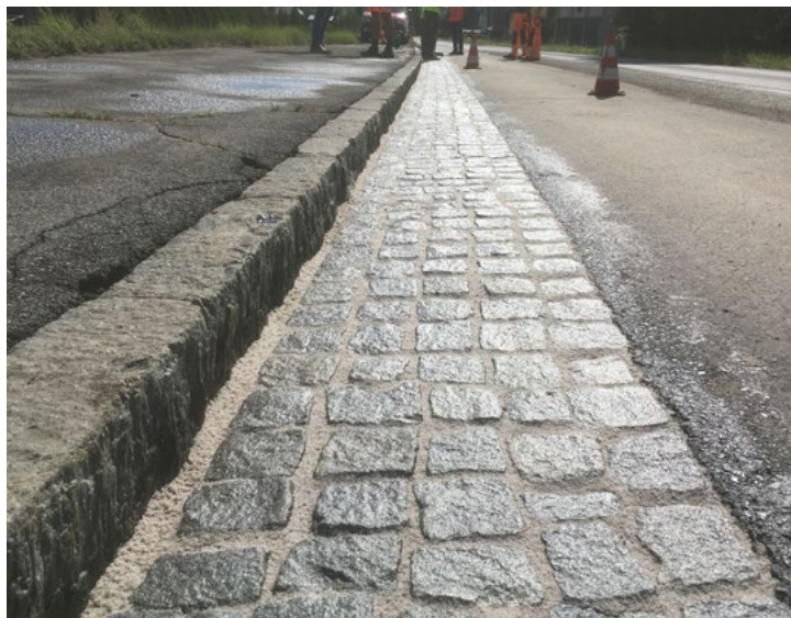
Sanovaný odvodňovací žlab
